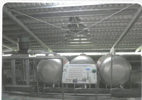
斜屋頂回收雨水，提供植栽用水，減少自來水使用。
